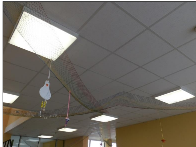
Schule/Eingangsbereich, veraltete Anbauleuchten
