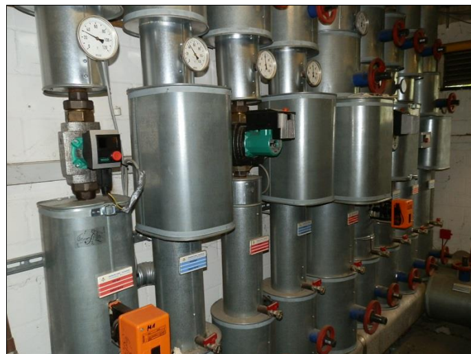
Heizraum Sporthalle/geregelte Umwälzpumpen
