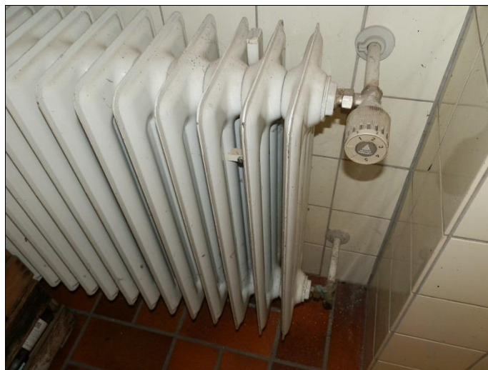
Heizkörper mit altem Thermostatventil
