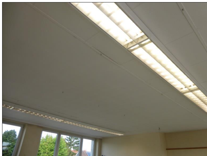
Altbau – Klassenraum/Rasterleuchten mit T8-Lampen und EVG
