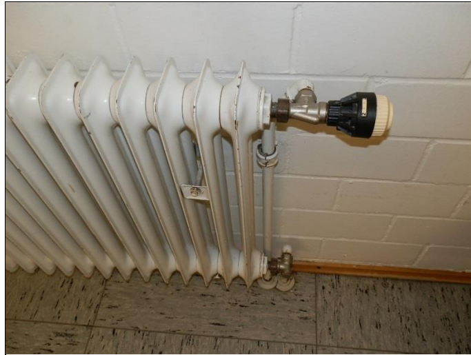
Sporthalle/Heizkörper mit Thermostatventil und Rücklaufverschraubung
