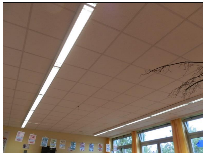
Grundschule/Klassenraum mit Rasterleuchten ohne EVG
