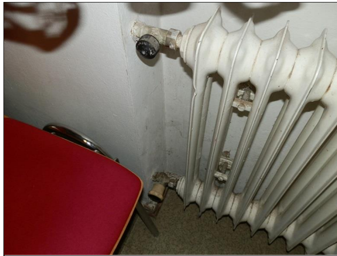
Heizkörper ohne Thermostatventil
