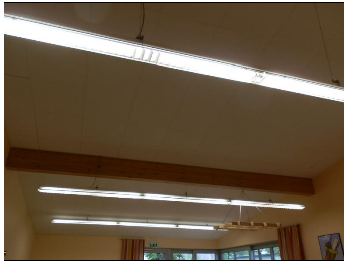
Mensagebäude/Betreuungsraum, Rasterleuchten mit EVG
