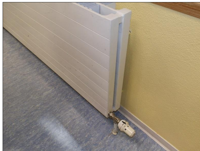
Schule – Anbau/Thermostatventil mit Voreinstellung, nicht einreguliert
