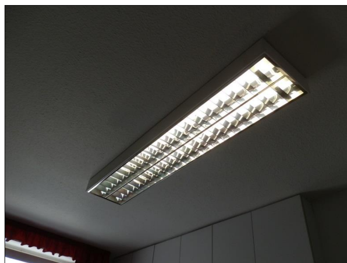
Büro Zentrale/Leuchten mit T8-Lampen und EVG
