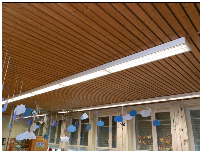
Schule – Anbau/Klassenraum 4, Anbauleuchten
