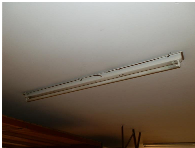
Halle/Geräteraum, alte freistrahlende Leuchte
