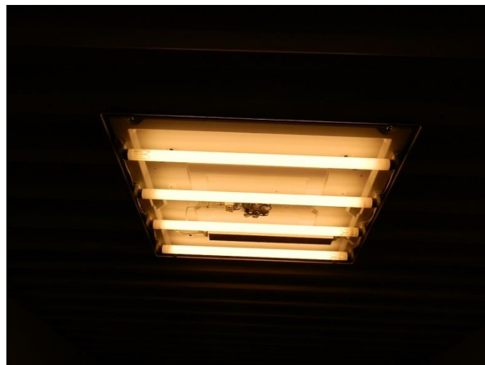
Sporthalle – Flur/alte Anbauleuchte ohne Abdeckung
