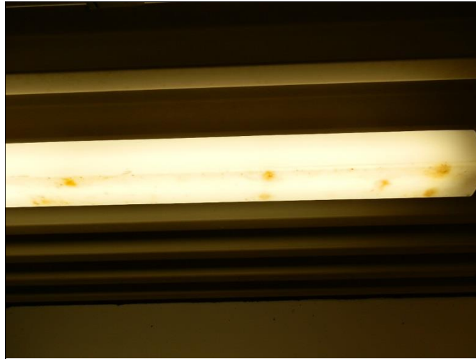
Sporthalle – Duschraum/alte Leuchte mit angelaufener Opalabdeckung
