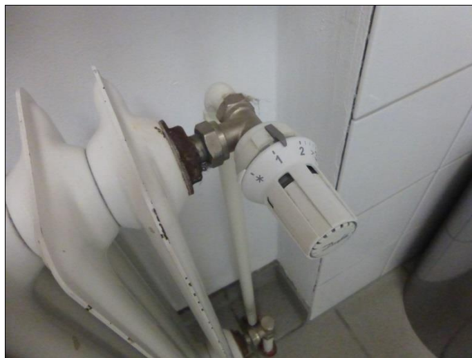
Altbau/Heizkörper mit voreinstellbarem Thermostatventil
