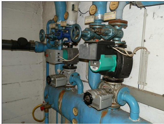
Alter Verteiler und Umwälzpumpen
