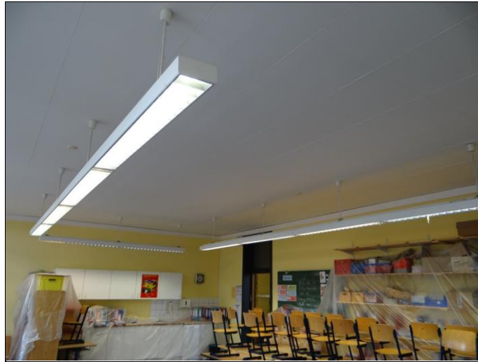
Altbau – Klassenraum mit alten Rasterleuchten
