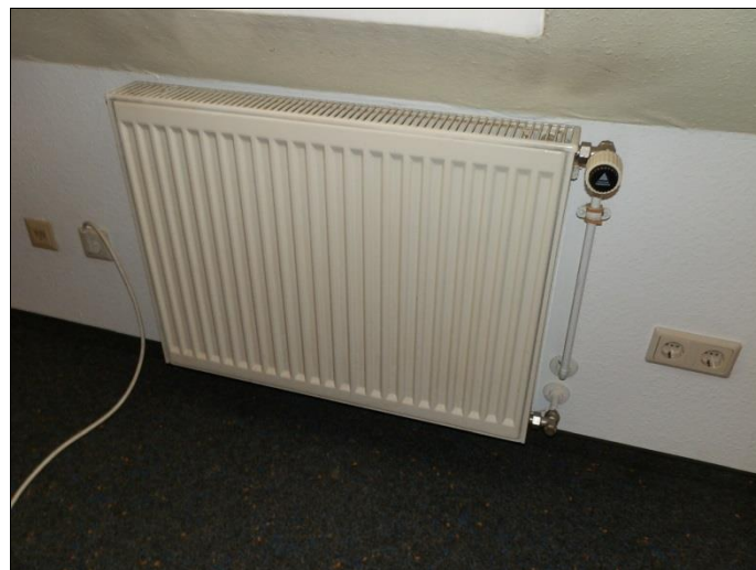
Nebengebäude/Heizkörper mit altem Thermostatventil
