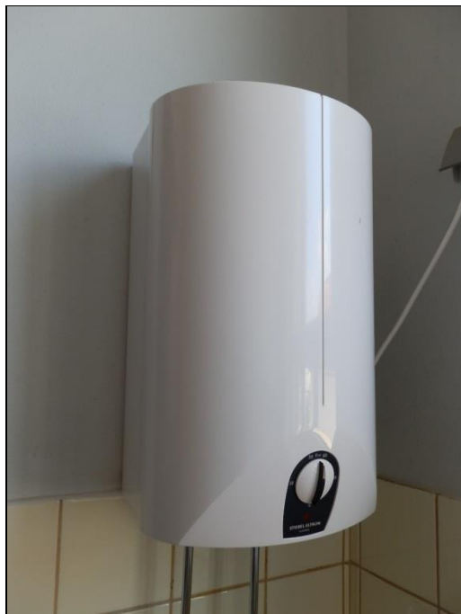
Elektrischer Warmwasserbereiter/Flur Schule - Altbau
