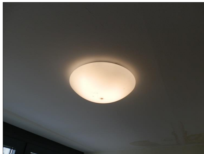
Toilette/Leuchte mit Kompaktleuchtstofflampe
