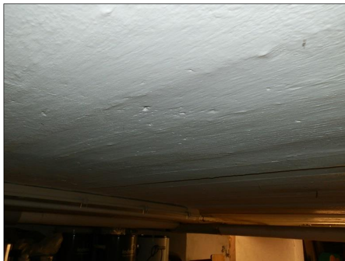
Altbau/Kellerdecke ohne Dämmung
