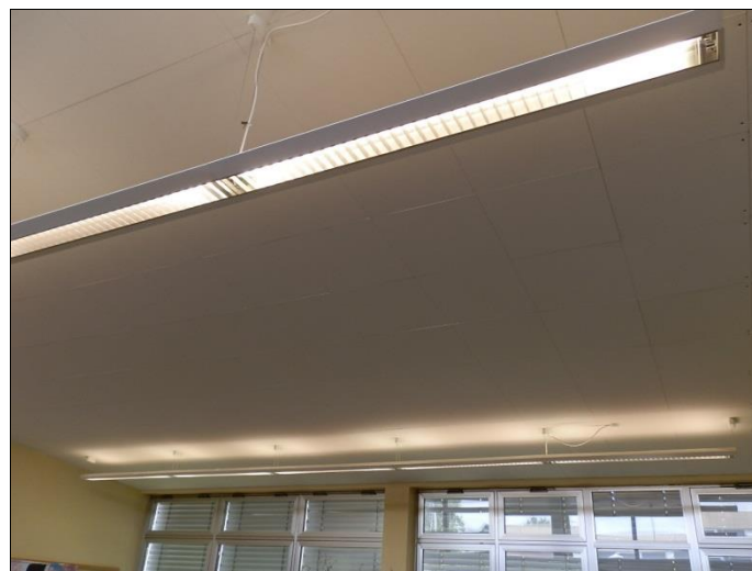
Schule – Klassenraum/neue Beleuchtung
