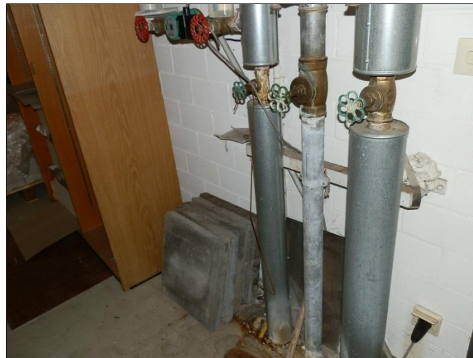
Zirkulationspumpe/Direktbetrieb über die Steckdose
