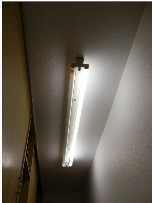
Flur OG/alte freistrahkende Leuchte
