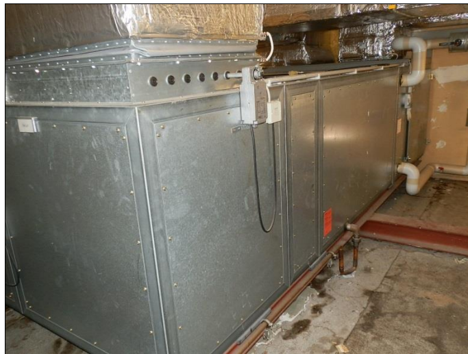
Raumluftechnische Anlage Halle
