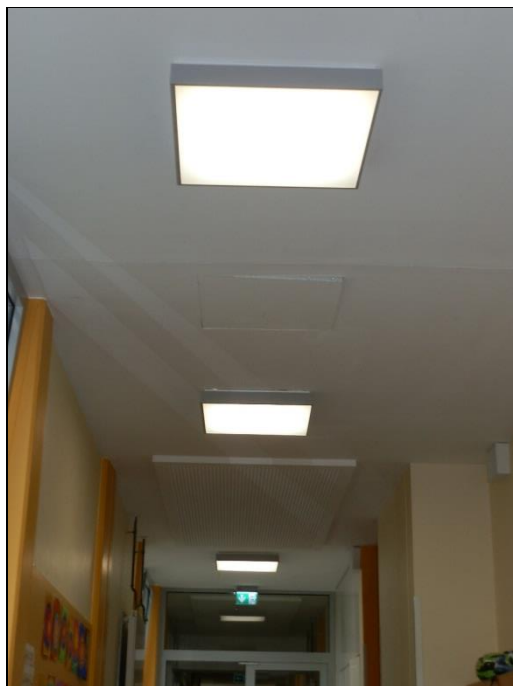
Grundschule – Flur EG/neue Leuchten mit LED-Lampen
