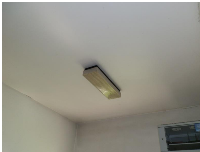
Küche/veraltete Anbauleuchte mit Leuchtstofflampen
