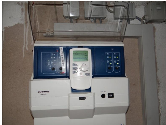
Regeltechnik Verteilerstation Schule - Altbau
