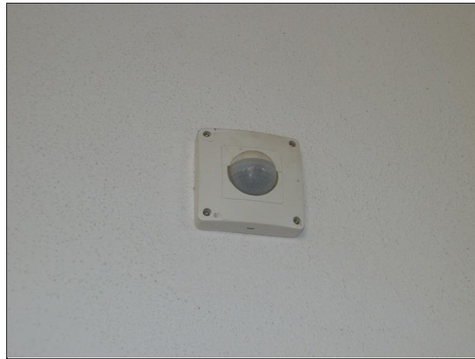
Flur/Bedarfssteuerung mittels Präsenzmelder
