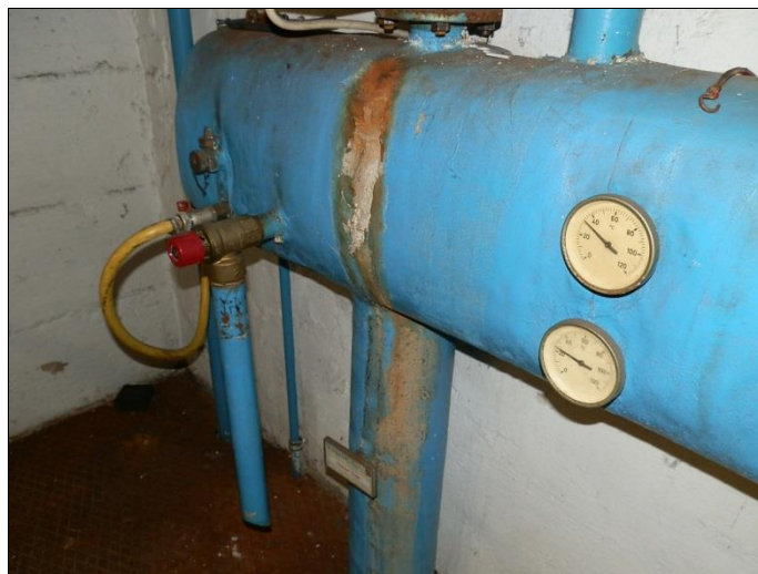
Alter Verteiler mit Gipsisolierung
