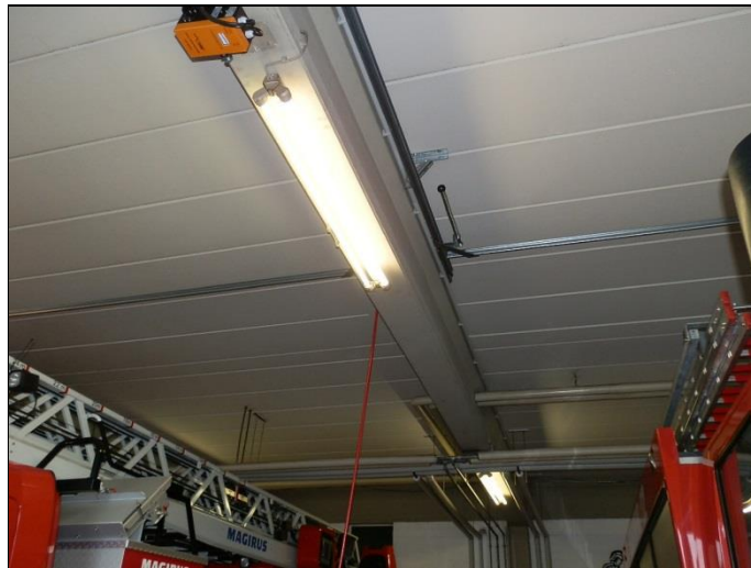
Fahrzeughalle/alte, freistrahlende Leuchte
