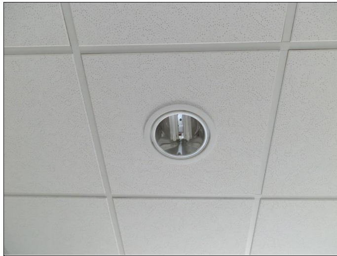
Toilette OG/Downlights mit Kompaktleuchtstofflampe
