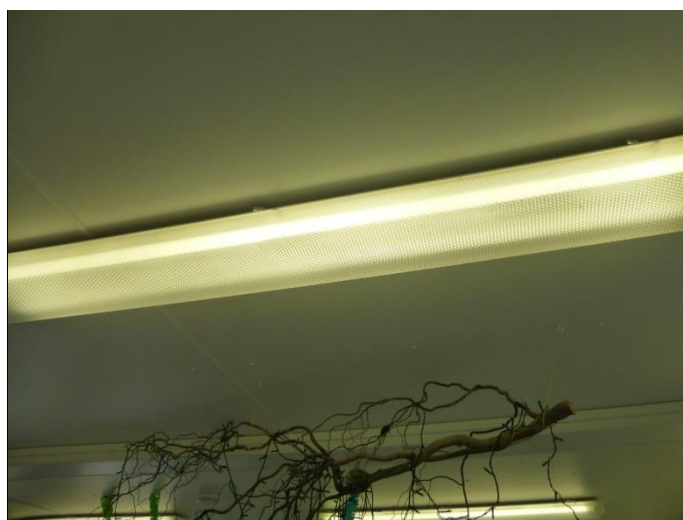
T8-Leuchtstofflampen mit Prismatikwannen
