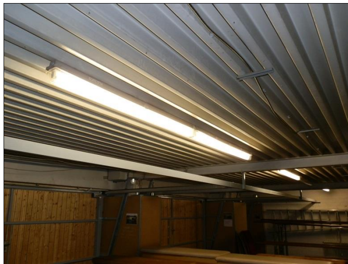
Sporthalle – Geräteraum/Anbauleuchte mit Prismatikabdeckung
