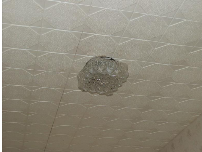
Vereinshaus/alte Leuchte mit Glühlampe
