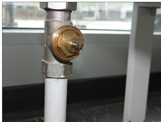
Altbau/Thermostatventil ohne Voreinstellung
