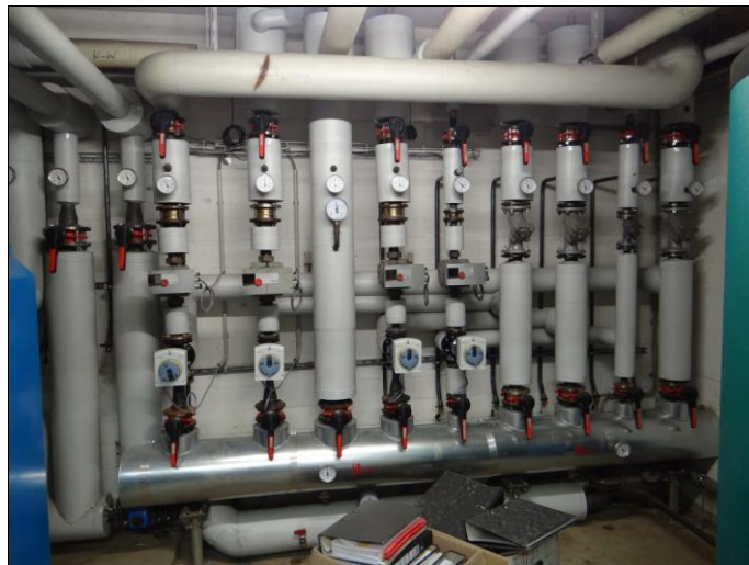
Heizraum KG/Hocheffizienzpumpen, Verteiler
