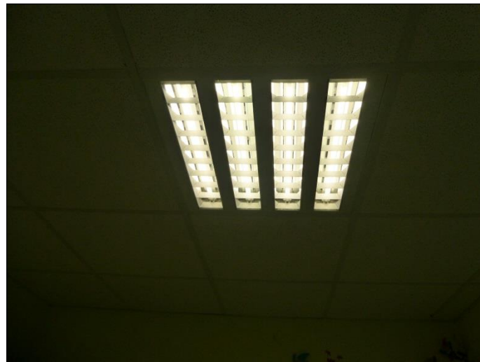
Altbau/neue Leuchten mit T5-Lampen und EVG
