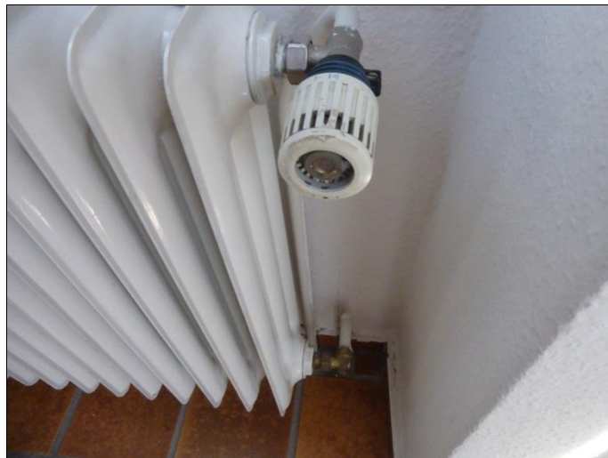
Heizkörper mit altem Thermostatventil
