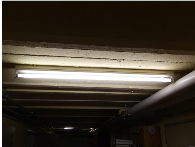
Flur UG/alte freistrahlende Leuchte
