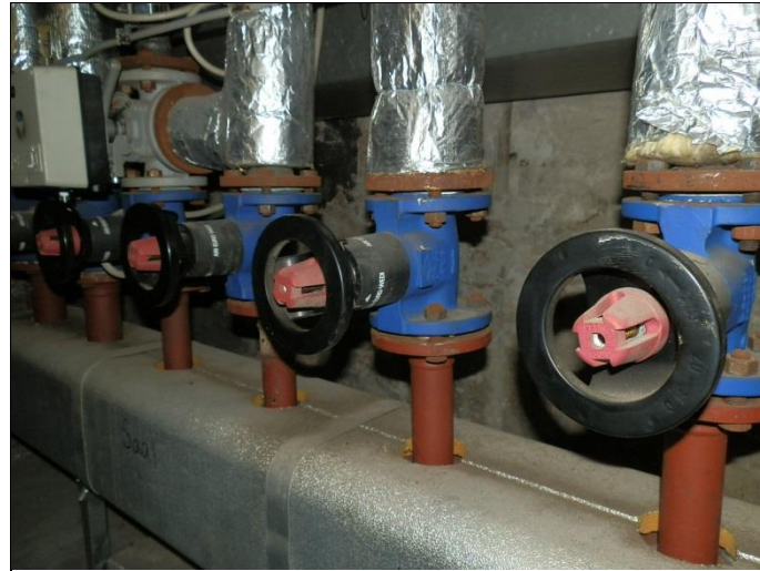
Absperrventile ohne Dämmung
