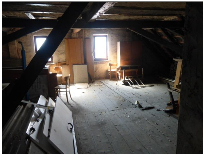
Dach und oberste Geschossdecke ohne Dämmung
