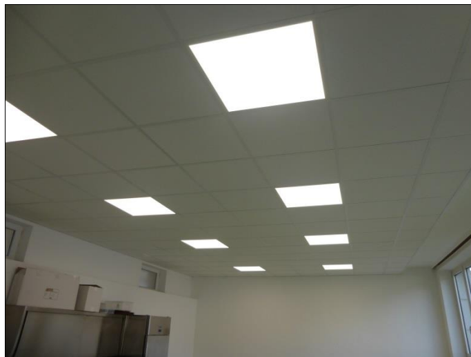
Altbau – Mensa/neue Leuchten mit LED-Lampen
