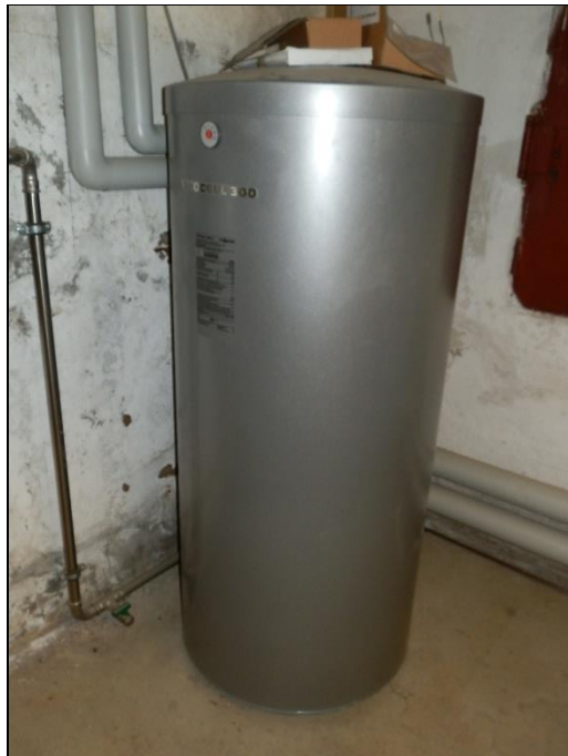
Zentraler Trinkwarmwasserspeicher Altbau
