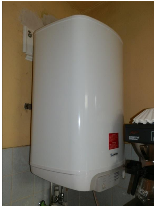
Elektroboiler Küche - Festhalle
