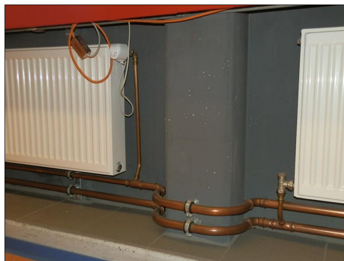
Grundschule/Heizkörper mit elektronischem Heizkörperventil
