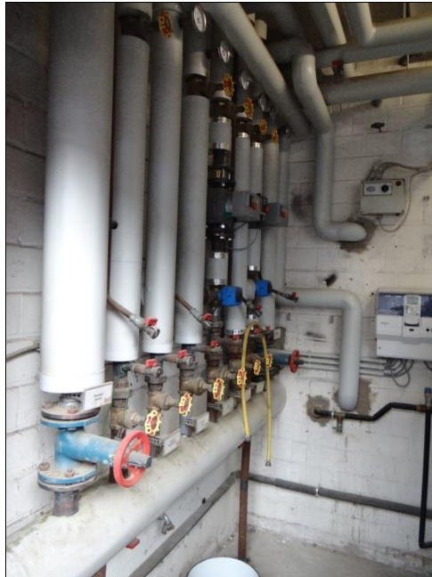
Absperrventile und Leitungen, zum Teil ohne Dämmung
