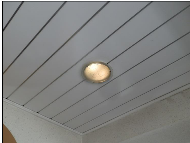
Festhalle – Eingangsbereich/Downlights mit Kompaktleuchtstofflampen
