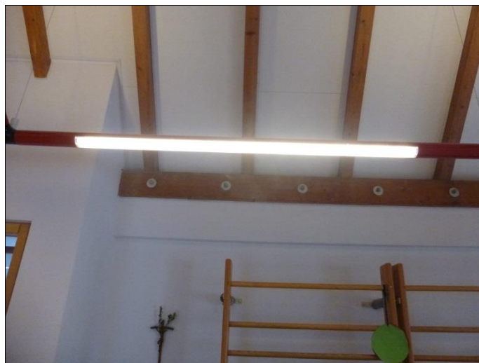
Neubau – Turnraum/abgehängte Rasterleuchten
