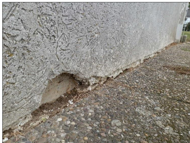
Schäden an der Außenwanddämmung
