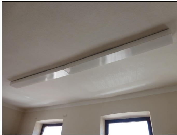
Altes Rathaus/veraltete Anbauleuchten mit Leuchtstofflampen
