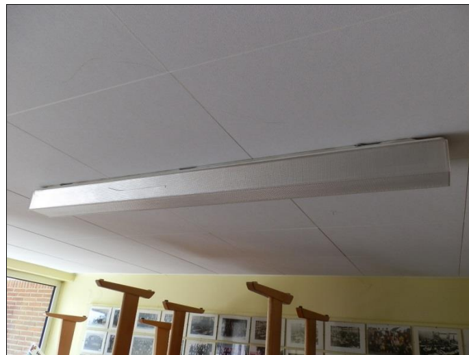
Schule – Eingangsbereich/alte Anbauleuchte
