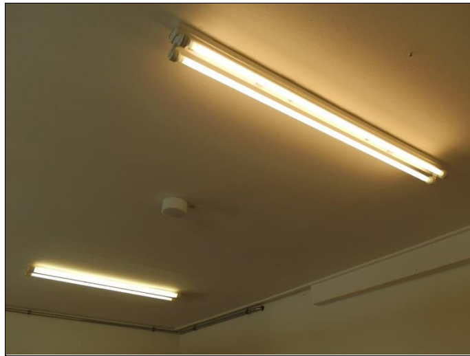
Mehrzweckhalle/Umkleideraum, alte freistrahkende Leuchten
