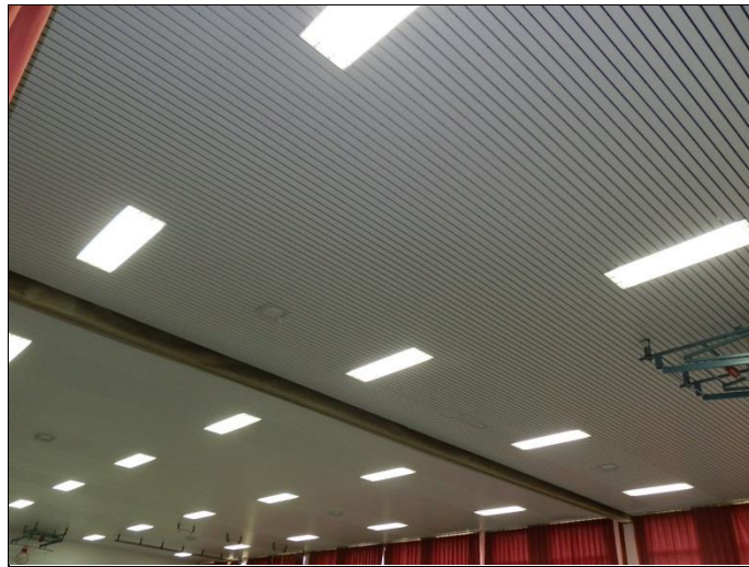
Hallenbeleuchtung mit T5-Lampen und EVG
