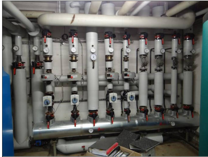
Verteiler mit ungedämmten Absperrklappen
