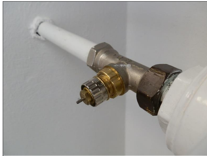
Schule – Altbau/einreguliertes Thermostatventil
