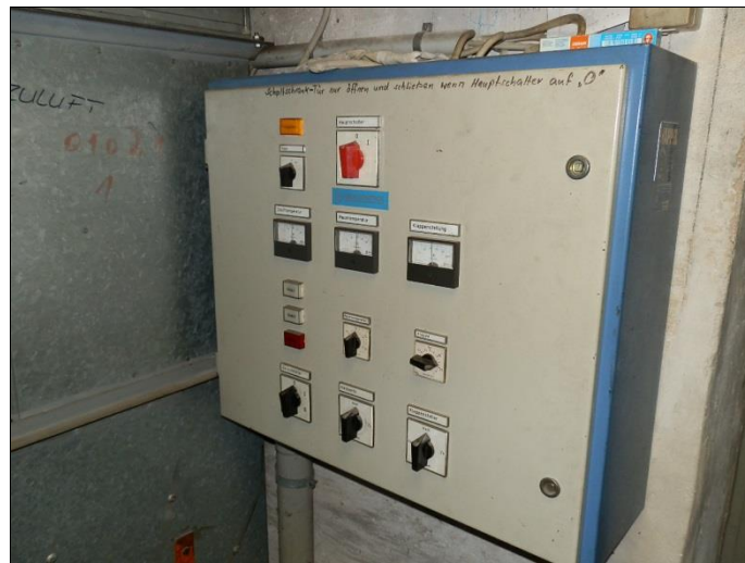
Alte Schaltechnik RLT-Anlage
