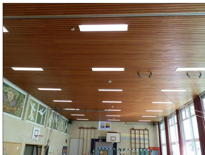
Hallenbeleuchtung mit dimmbaren EVG
