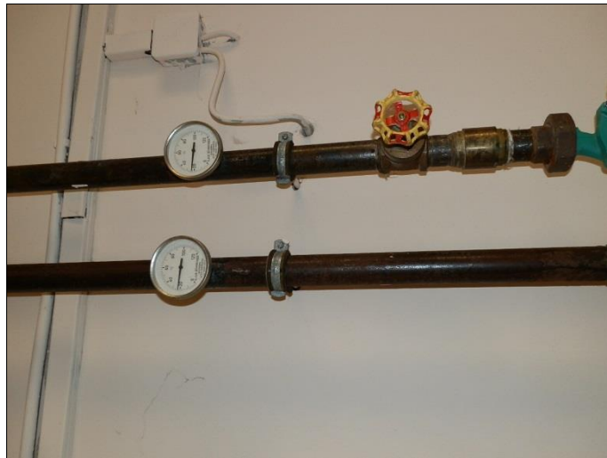
Heizleitungen und Absperrventile ohne Dämmung
