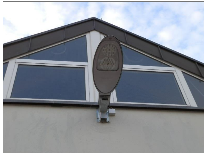
Neue LED-Leuchte im Außenbereich
