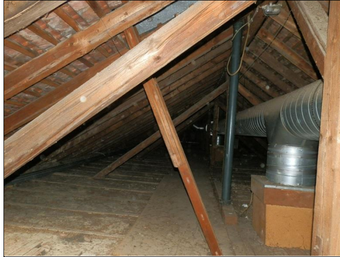
Dachbereich ohne Dämmung
