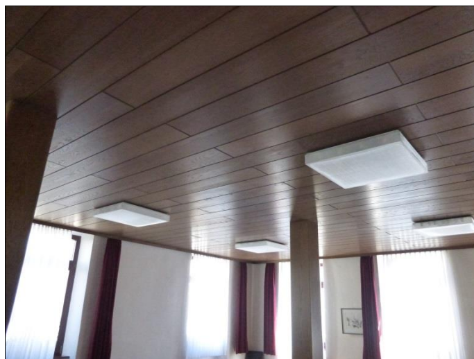
Altes Rathaus/alte Leuchten mit Prismaabdeckungen
