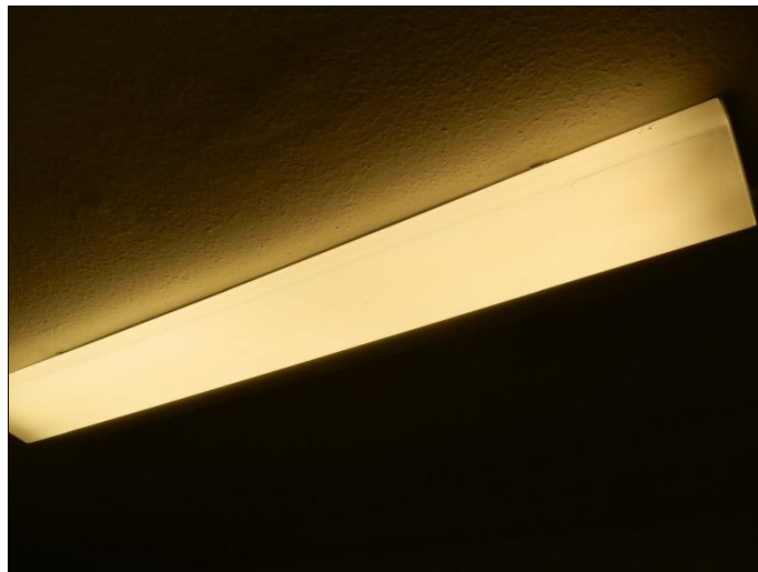
Alte Leuchte Küche Nebengebäude
