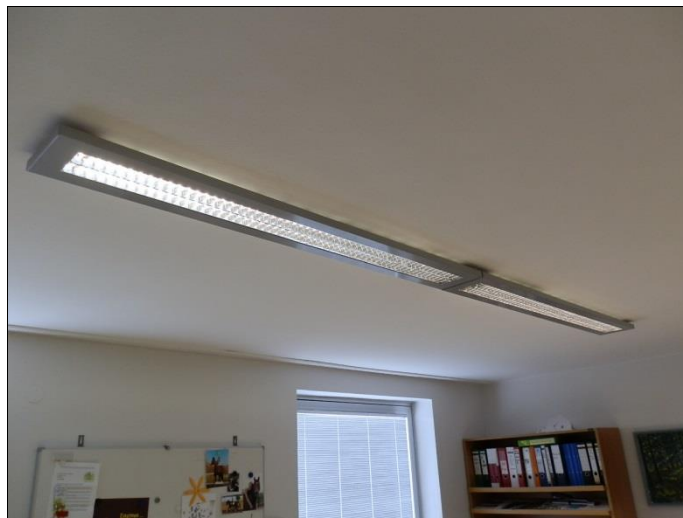
Schule – Schulleitung/neue Rasterleuchten mit T5-Lampen und EVG
