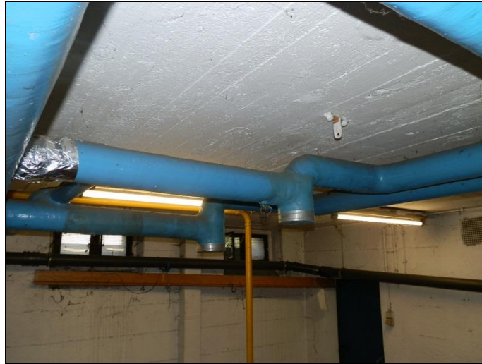
Altbau/Kellerdecke ohne Dämmung
