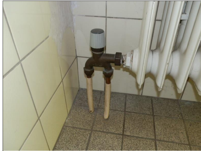
Toilette/Heizkörper mit altem Thermostatventil
