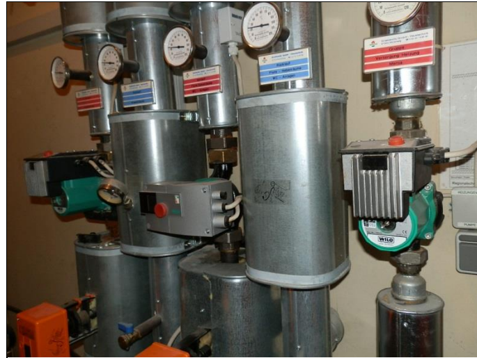
Unterstation Grundschule/geregelte Umwälzpumpen
