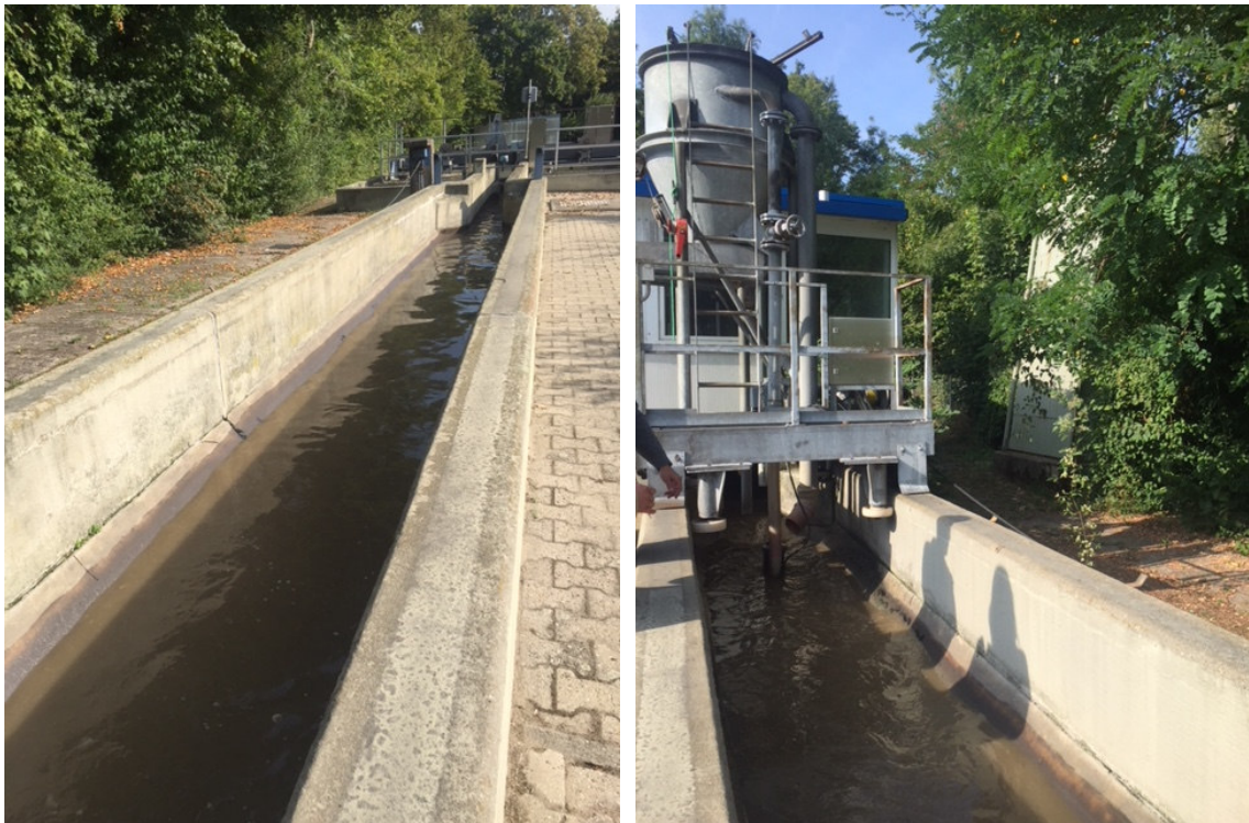
Bild 17 + 18: Sandfangbecken und Räumerbücke
