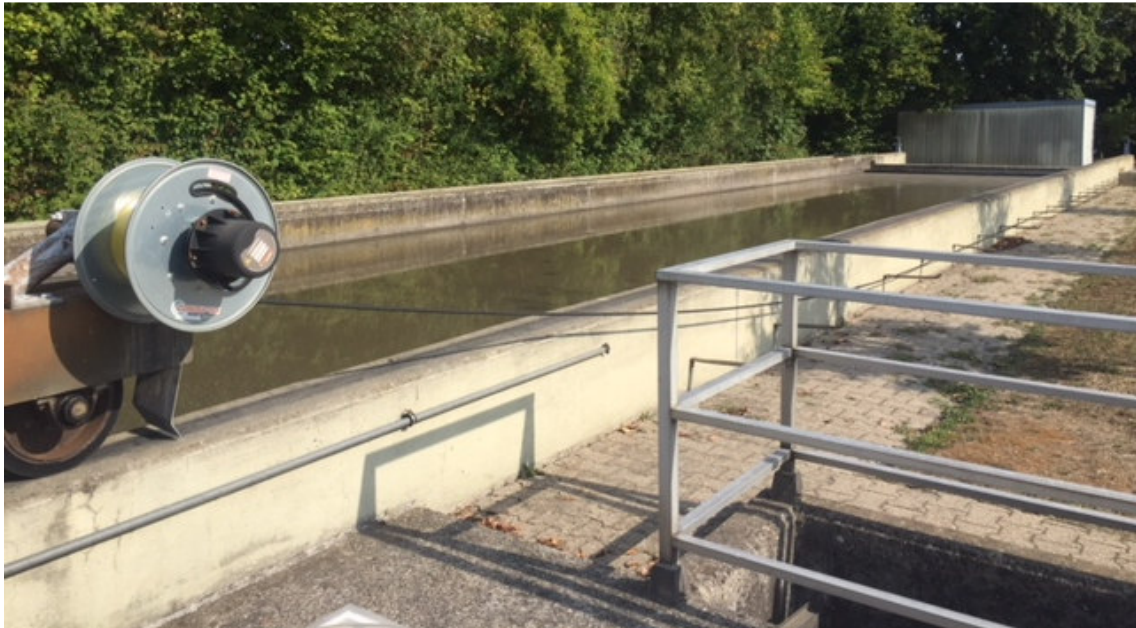
Bild 19: Vorklärung KA Römerberg
