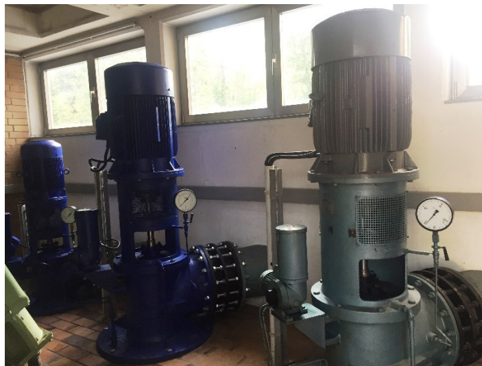
Bild 26: Hochwasserpumpen der KA Römerberg
