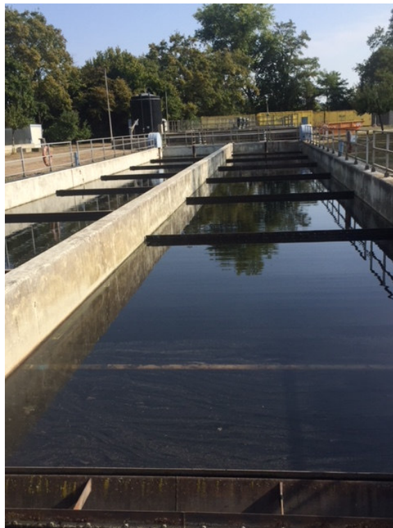
Bild 21: Nachklärbecken der KA Römerberg
